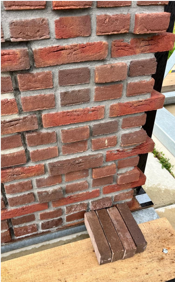
Pad langs muur
