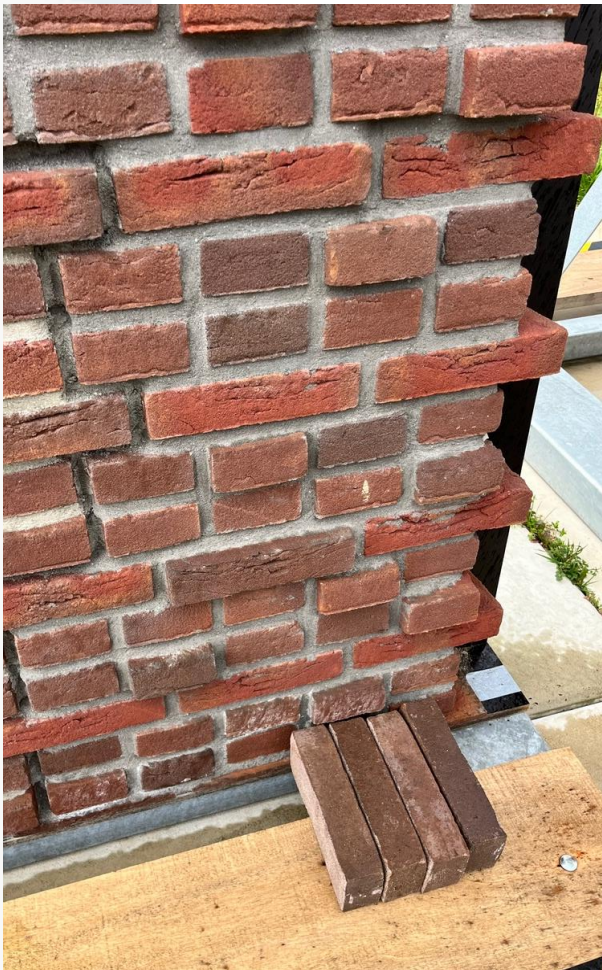
Pad langs muur
